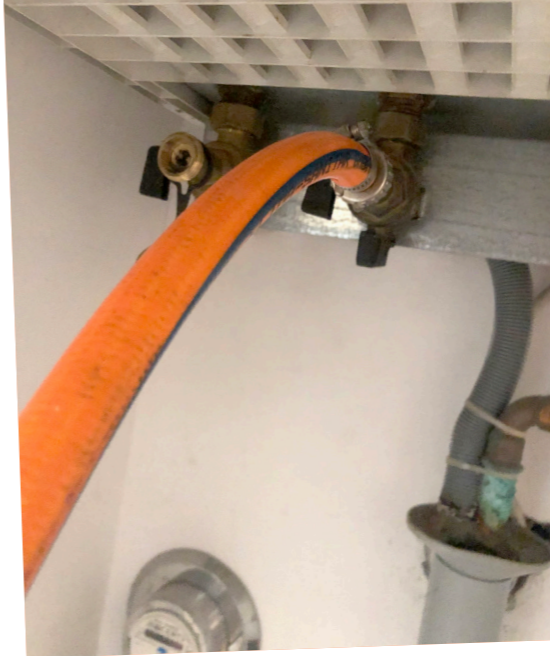
Amateuraufnahme einer Wasserzuleitung für eine Therme
